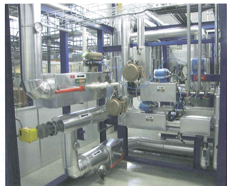
La conception en trois "skids" distincts et déplaçables qui sont des sous-ensembles fonctionnels préfabriqués et testés, facilite grandement la maintenance de cet imposant banc d'essai par le personnel d'Itron.
